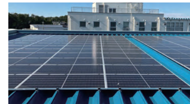
安裝在三友半導體工程的太陽能面板
