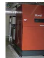
2014年度に設置したLPGを燃料とする空調用LPGボイラー
