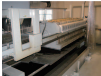
更新した脱水機 (フィルタープレス式)
