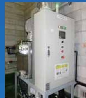
潤滑油廃液の濃縮処理装置
